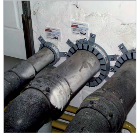
Kuhn Brandschutz Systeme
